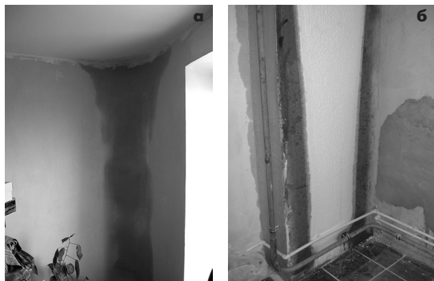
Рис.1. Последствия нарушения работы систем естественной вентиляции жилых зданий: а) выпадение конденсата в углах наружных стен вследствие высокой влажности воздуха; б) обмерзание вентиляционных блоков вследствие опрокидывания движения воздуха
